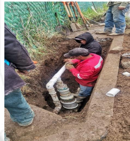
Atendiendo fuga de agua
