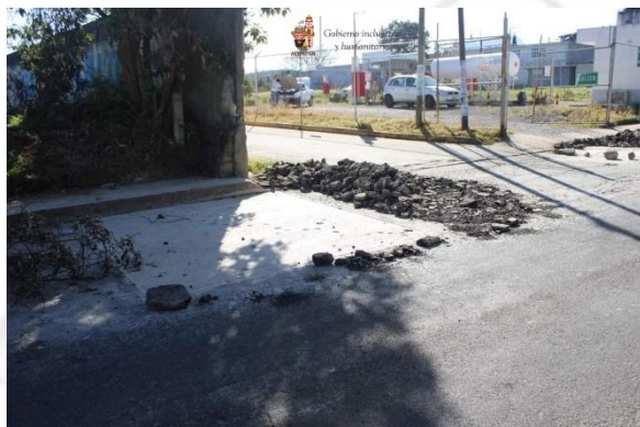
Bacheo en gasera tramo el Carmen
